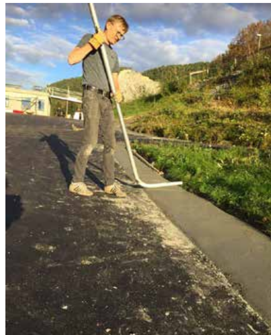
Avdelingsleder Rune Rødset i aksjon med å støpe nye curbs. Foto: Stefan Lausund
